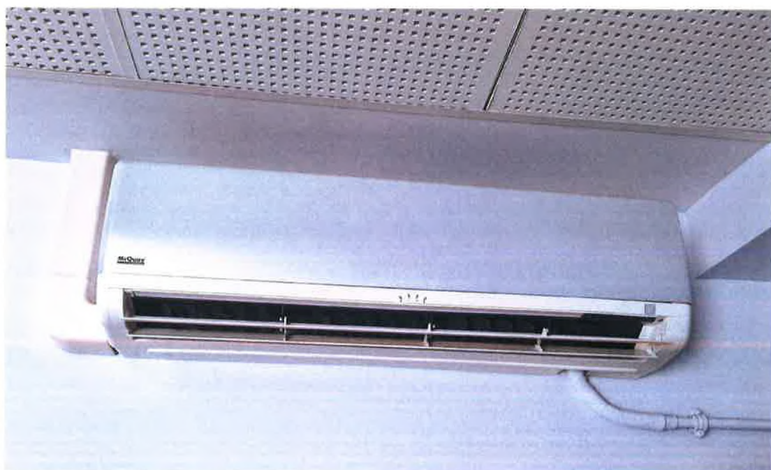
Klimatyzator podlegający utylizacji
