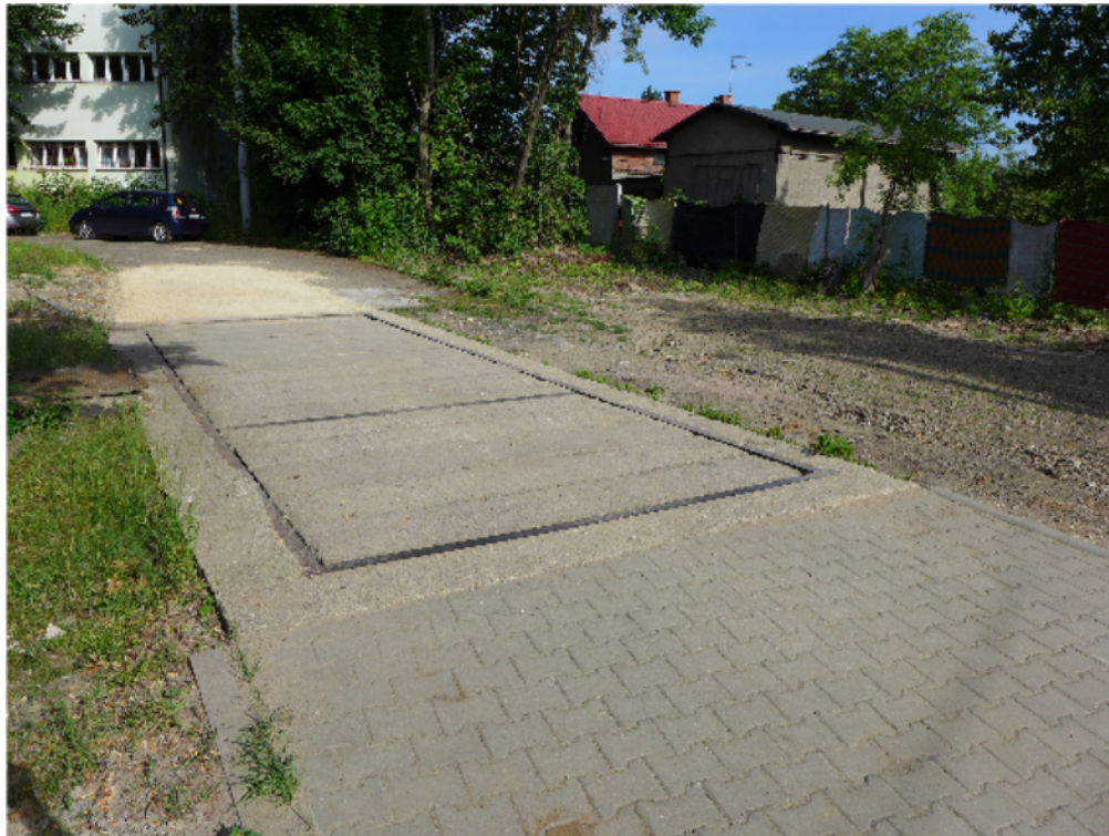
Fot.2. Waga samochodowa przewidziana do częściowej rozbiórki.
