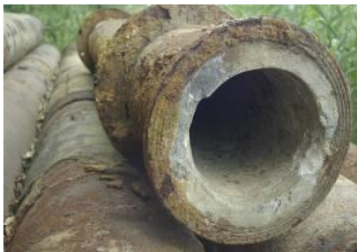
Rysunek 4. Wytrącający się osad na wewnętrznych ściankach rurociągów kopalnianych (Mrdakovic Popic i in. 2023)
