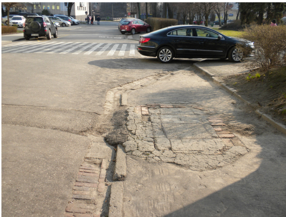
Fot.3. Studnia teletechniczna przewidziana do wymiany. W tle widoczne przejście wymagające korekty z uwagi na nieprawidłowe parkowanie
