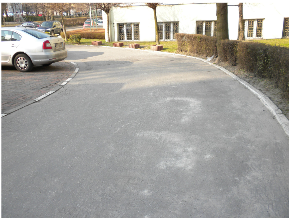
Fot.6. Parking półokrągły wraz z jezdnią do remontu
