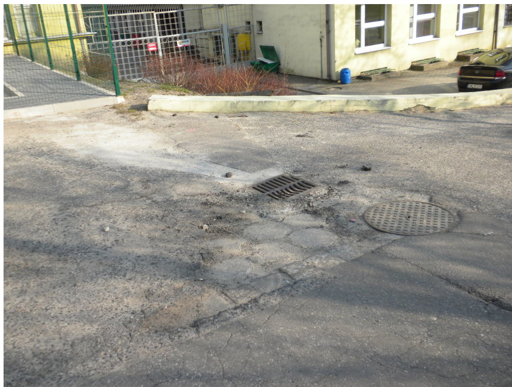
Fot.1. Rejon lokalizacji odwodnienia liniowego. Widoczny wpust do likwidacji oraz konstrukcja i typowe uszkodzenia nawierzchni.
