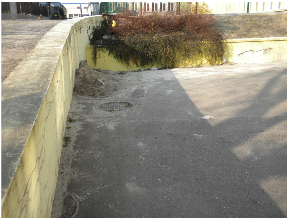
Fot.5. Murki oporowe – typowe uszkodzenia. W tle widoczny daszek i skarpa do zabezpieczenia.
