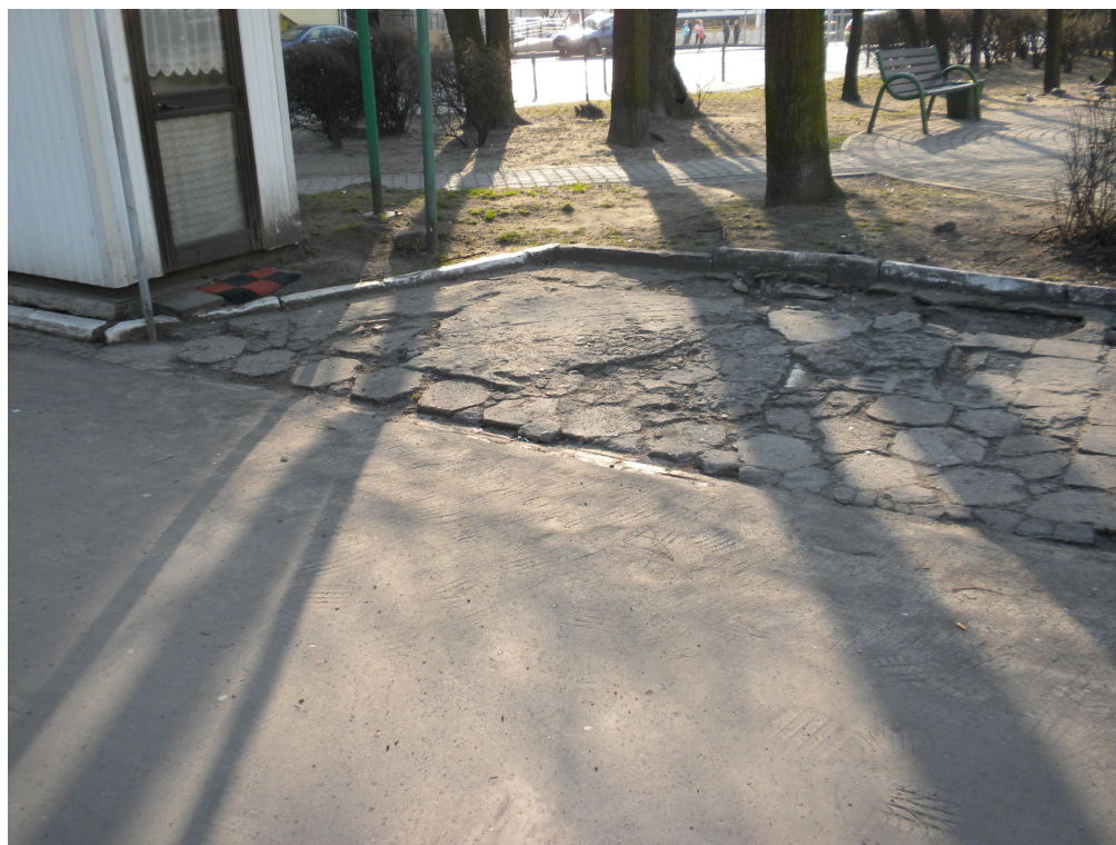
Fot.2. Miejsca postojowe. Typowa nawierzchnia i uszkodzenia
