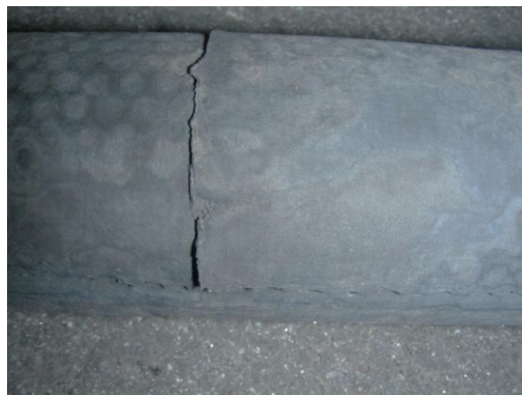
Rys. 3.9 Uszkodzenia wkładu F_M_01.
