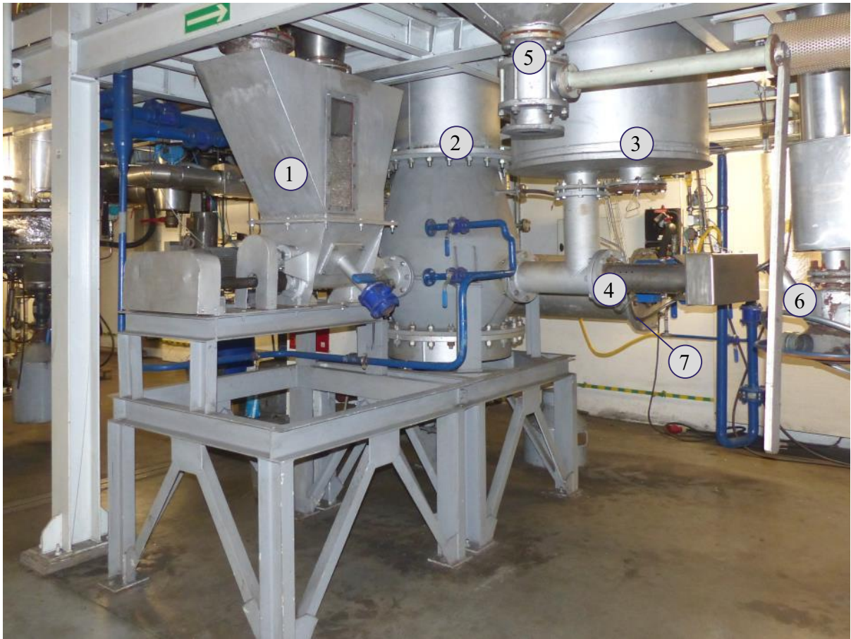
Rys. 8.2 Widok dolnej części instalacji IPPS: 1) główny zbiornik paliwa, 2) reaktor, 3) zbiornik recyklu, 4) dozownik recyklu, 5) zbiornik magazynowy przelewu z recyklu, 6) punkt odbioru pyłów z baterii cyklonów.
